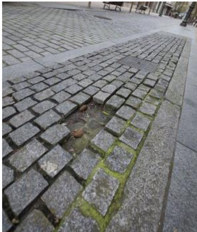
Figura 39 ejemplo de calles con adoquines faltantes
