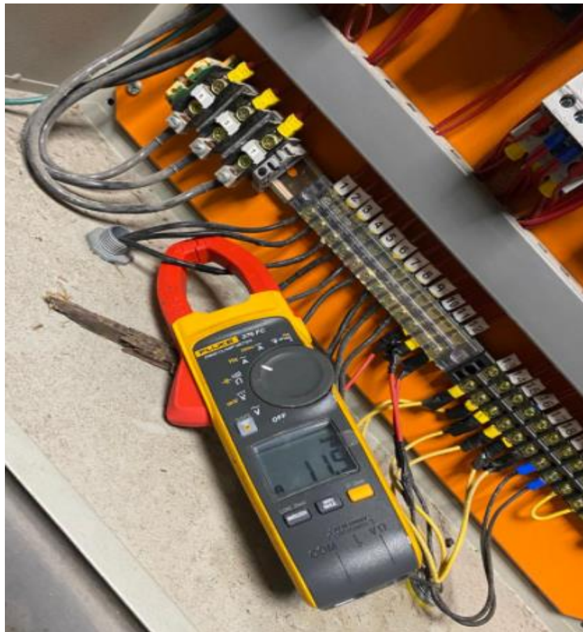
Ilustración 30 Corriente nominal de bomba 1
