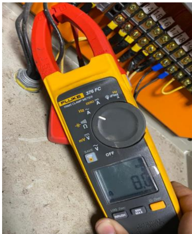
Ilustración 32 Corriente nominal de bomba 3
